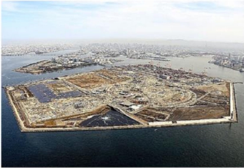
万博に向けた建設が進む夢洲19日、大阪市此花区、朝日放送テレビヘリから、水野義則撮影
